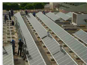
Instalación IMPRO Puerto Real (Cádiz)
